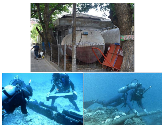
Gambar 4. Pembangkit Listrik Tenaga Diesel yang ada di Pulau Panggang
