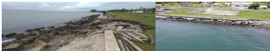
Gambar 4. Kerusakan Talud Sumber: Survei Lapangan (2023)
