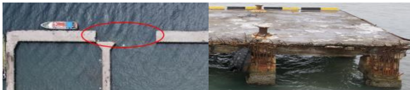
Gambar 3. Kerusakan Segmen Dermaga Sumber: Survei Lapangan (2023)
