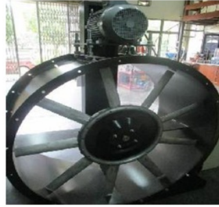
(b) Exhaust Fan
